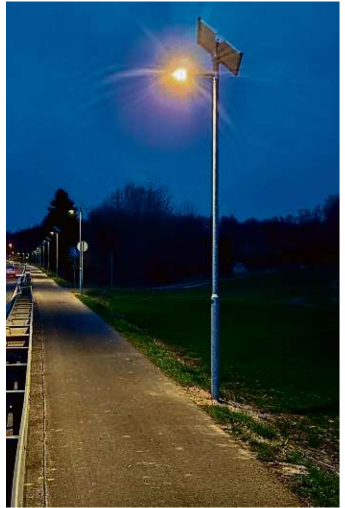
LED-Solartechnik leuchtet am Radweg zwischen Bernbach und dem Gewerbepark Birkenhain.
