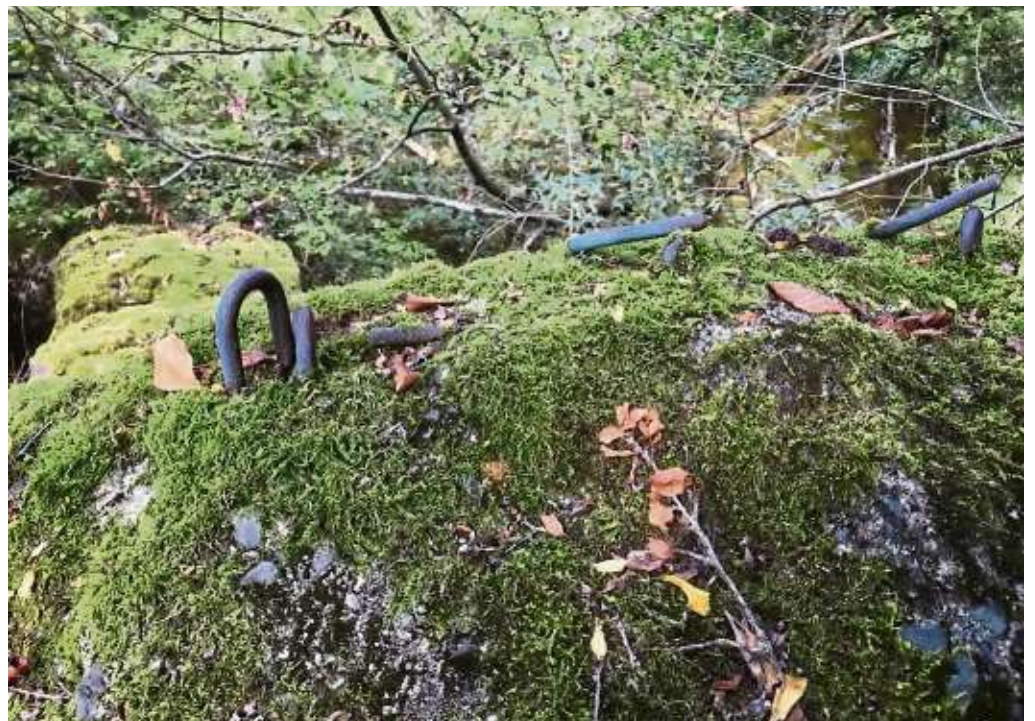
An vielen Stellen ragen Armierungen aus dem Stahlbeton.
